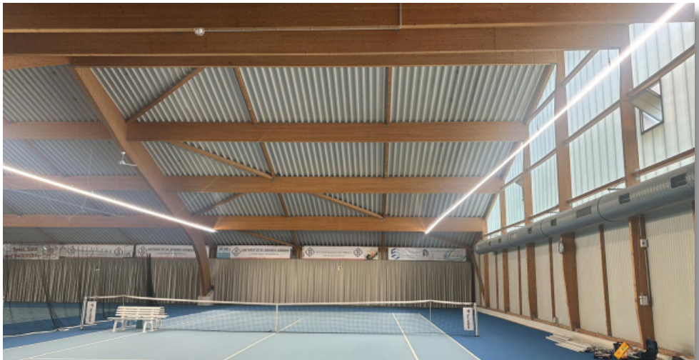
Tennishalle mit neuer Beleuchtung
